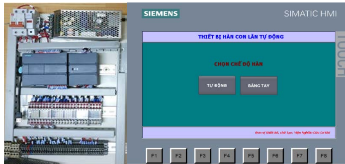
Hình 9. Bố trí linh kiện bên trong tủ điều khiển và màn hình HMI
