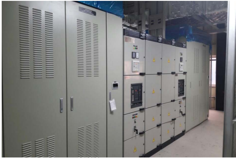
Tủ máy cắt cho hệ thống lọc bụi tĩnh điện (ESP)
