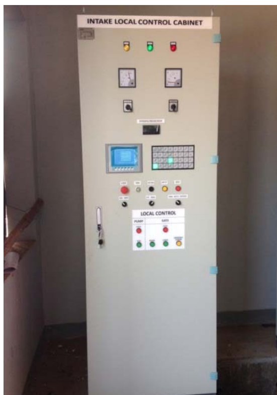
Tủ điều khiển tại chỗ cửa nhận nước
