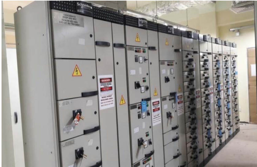
Tủ điều khiển động cơ búa gỗ – ESP NB TB1
