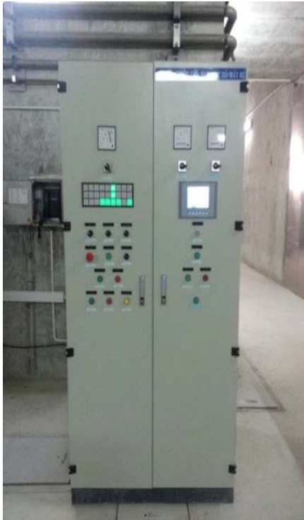
Tủ điều khiển tại chỗ cửa xả sâu
