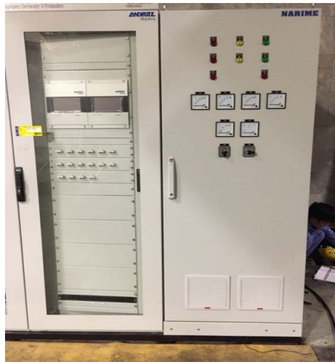
Tủ cấp nguồn AC/DC
