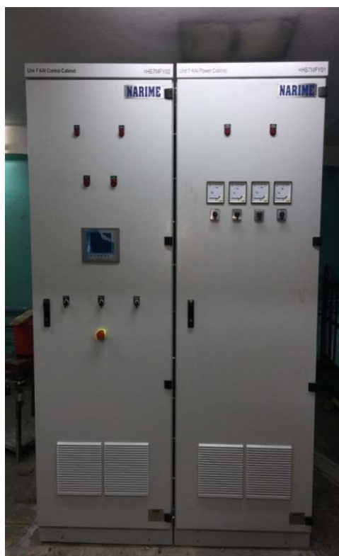
Tủ điều khiển thủy lực
