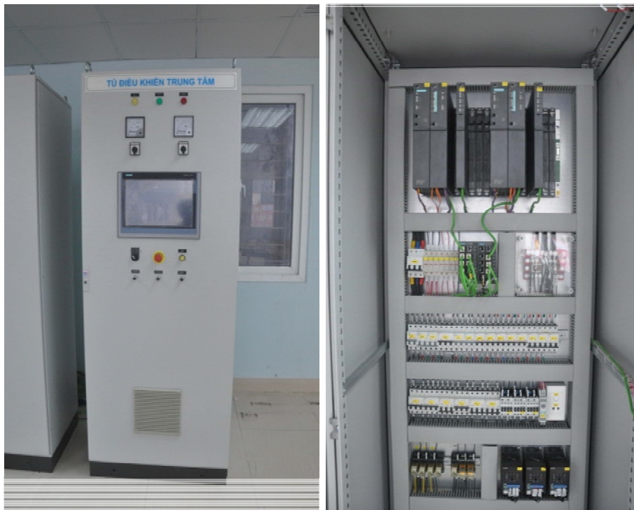
Tủ điều khiển trung tâm hệ thống lọc bụi
