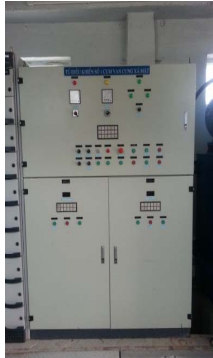
Tủ điều khiển tại chỗ cửa xả mặt
