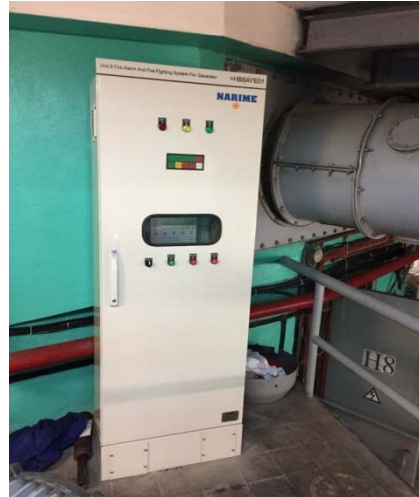
Tủ báo cháy và chữa cháy máy phát
