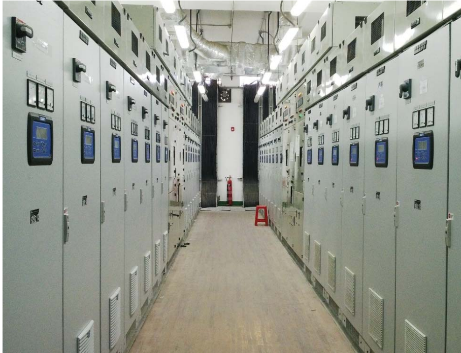
...tủ điện động lực, điều khiển thiết bị công nghệ
