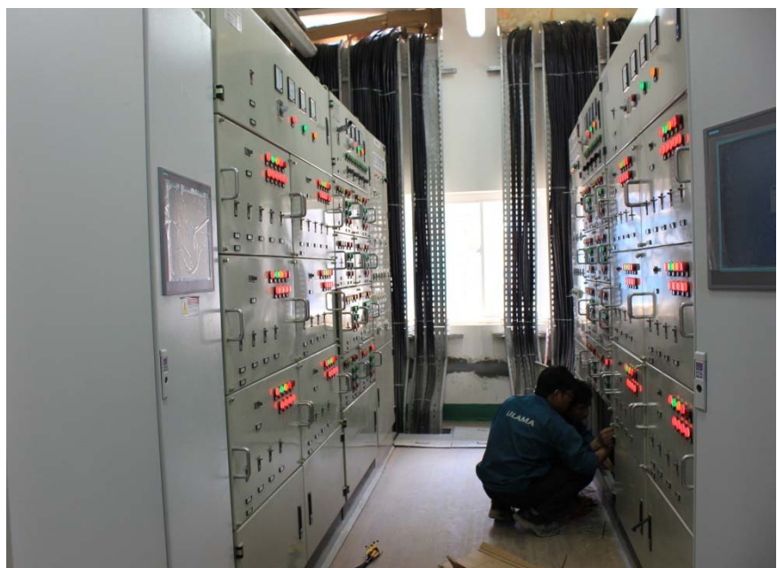
...tủ điều khiển biến thế chỉnh lưu...
