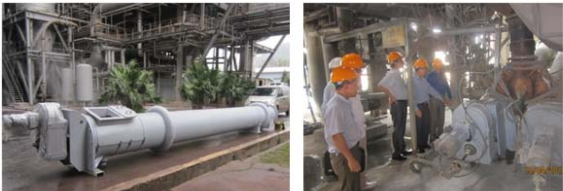
Hình 4. Thiết bị làm mát xỉ được chế tạo, lắp đặt và vận hành tại NMNĐ Na Dương
